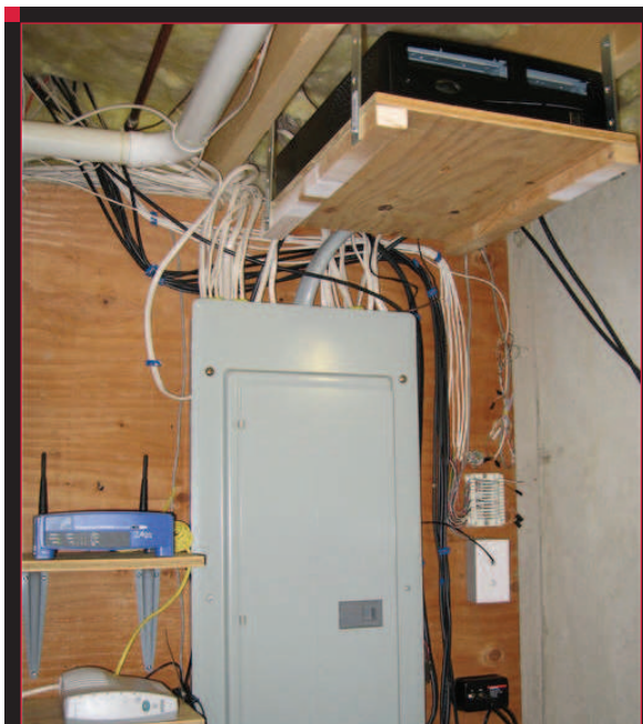
■ 4. ábra Napi 24 órás telefonszolgáltatást biztosító Skype kiszolgáló. Maga a gép a fénykép felső részén látható, a kábelmodem és a vezeték nélküli router balra, a házi telefonvezetékek kapcsolótáblája pedig jobbra. A kép közepét a villanyórszekrény foglalja el.
