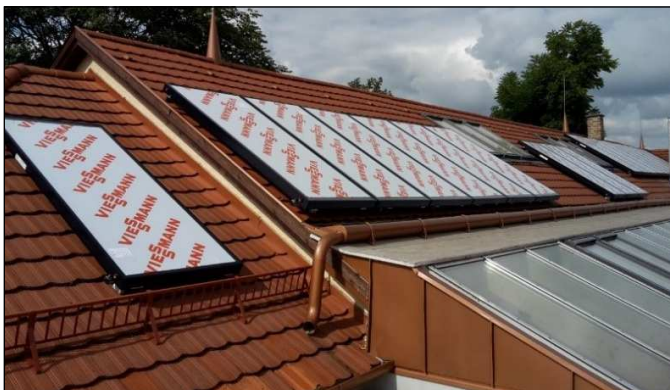
Napkollektorok a Rácalmási Manóvár Óvoda és Bölcsőde tetején (védőborítással)
