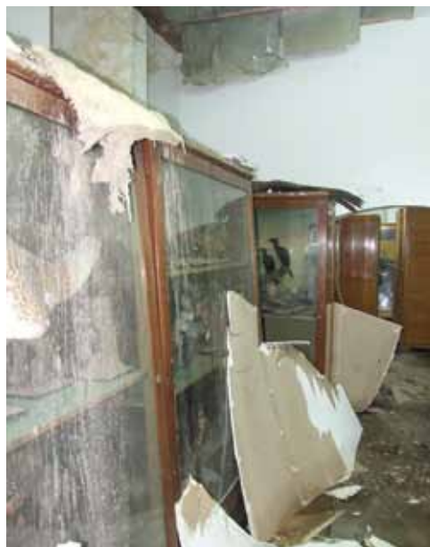
1. kép. A beázott raktárhelyiség részlete. Leszakadt mennyezet, padlót ellepő törmelék, beázott szekrények.
