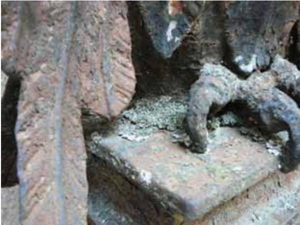
3-4. kép. Felvált, pergő festékrétegek, rozsdás fémfelületek.
